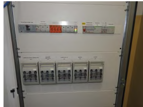
Zabezpieczenia nowej rozdzielni
